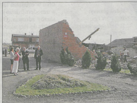
Silny wiatr pozrywał dachy z budynków
