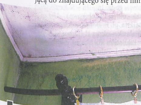
Narożnik pokoju pod dachem, w którym zimą woda skrapla się na ścianach i suficie, a czasami występuje nawet szron fot. Piotr P. Ruszkowski
