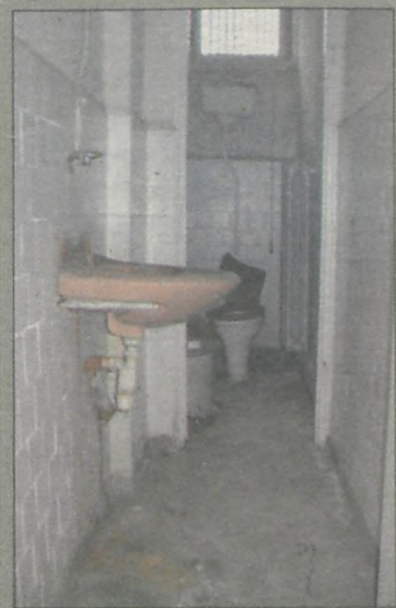
INSTALACJE CENTRALNEGO OGRZEWANIA i elektryczna nadają się do całkowitej wymiany, podobnie jak sanitariaty
