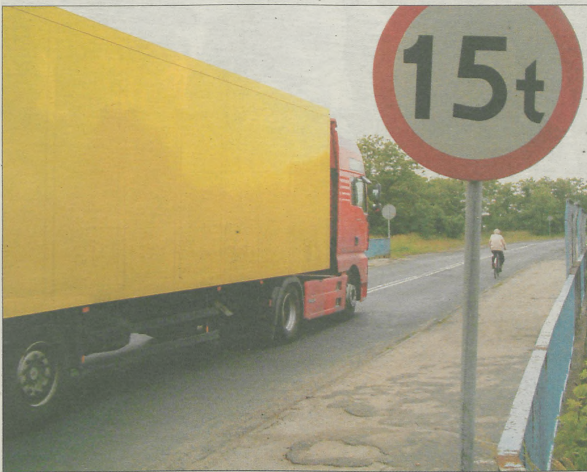
ZDANIEM SPECJALISTÓW WIADUKTY na ul. Powstańców Wlkp. nadają się jedynie do zburzenia. Tymczasem tą trasę wybiera wielu kierowców ciężarówek
